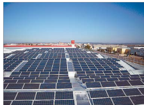
Vista del tejado solar instalado en el polígono El Cabezu II. / LT
